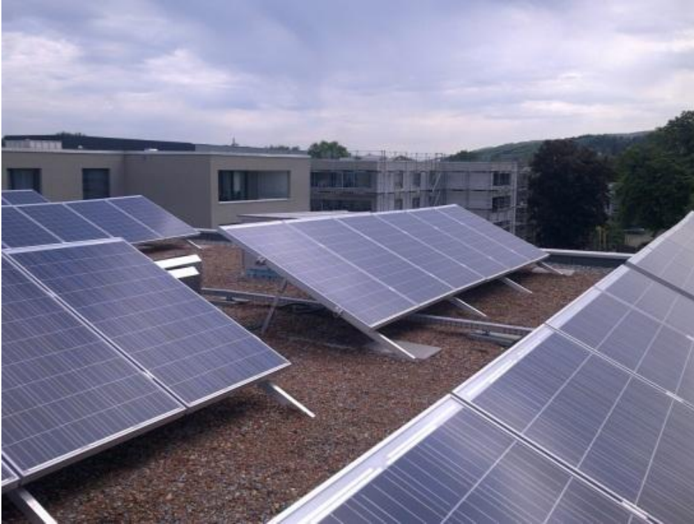
Abbildung 2: KEV-Solarstromanlage Schmidgasse in Frauenfeld
